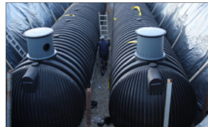
Die Tanks sind mit KG-Rohren verbunden.
