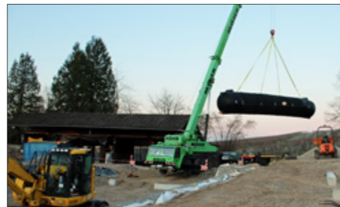
Innerhalb von jeweils nur 20 min wurden die Tanks vom Lkw in die Baugrube gehoben.
