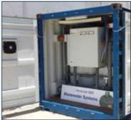
Armário de controlo integrado
