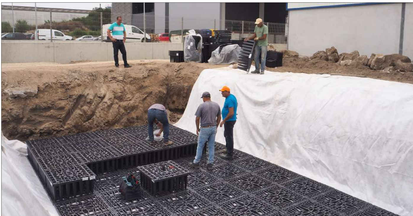
Colocação dos blocos em linhas completas em formato escada para facilidade de instalação
